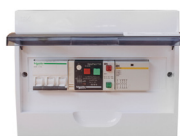
Шкаф управления ШСАУ-В
