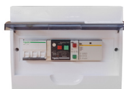
Шкаф управления ШСАУ-В
